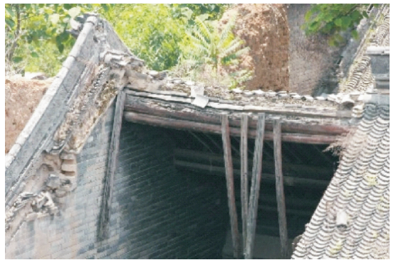
图13 残破的“过厅”屋顶
